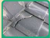
瓦のひび割れ・ずれ
