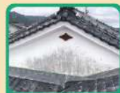
経年劣化による黒ずみ
