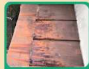
錆による腐食
