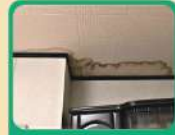
雨漏りによる天井のシミ
